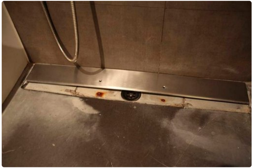
Viiden tähden hotellissa ei ruuvien pitäisi ruostua, eikä lattiakaivon kansien olla irti.
