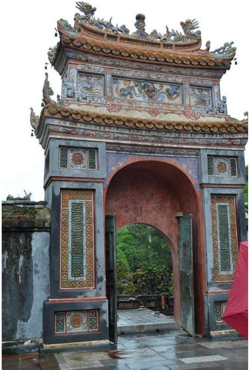
Tu Ducin mausoleumin sisäänkäynti tapahtuu jyrkän portin kautta. Linnoituksen muurin rappaukset kaipaavat korjausta.
