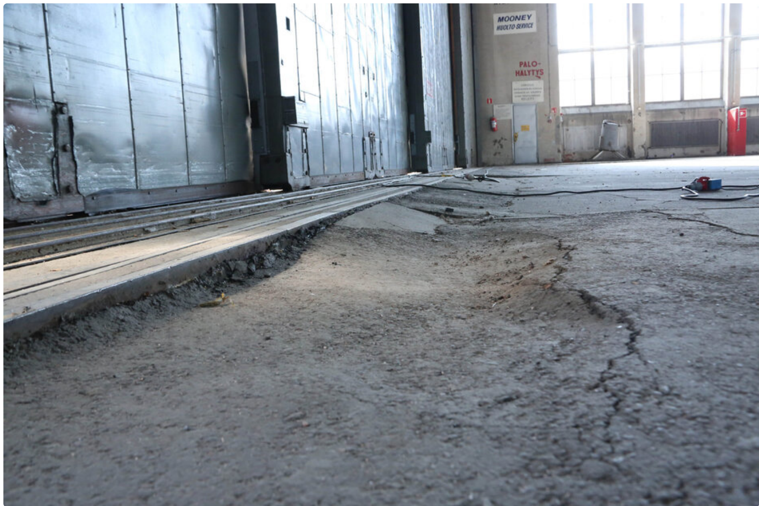
Malmin hallin romahtanut lattia. Lähde: www.malmiairport.fi
